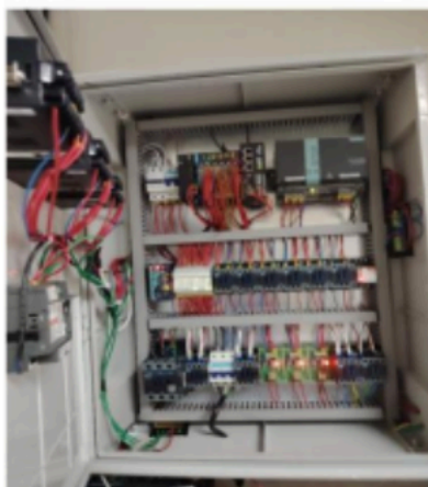
Panel de Supervisión y control Solar, Hídrico y Aerotermia
